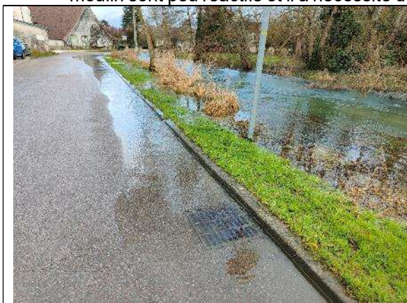
Bouche d'égout qui refole
