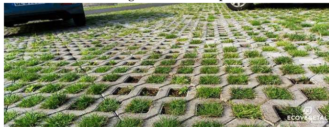
Parking alvéolaire perméable
