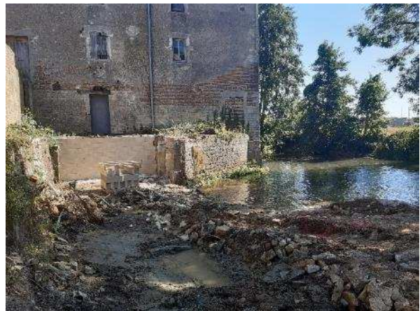
Fermeture chambre d'eau
