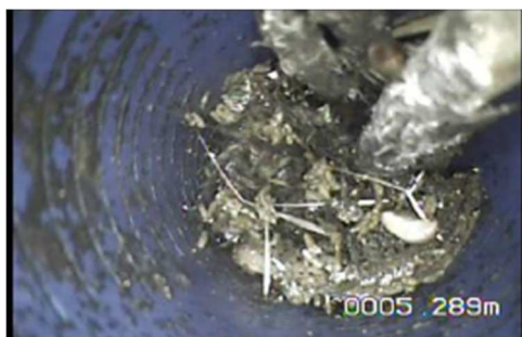
Débris végétaux en fond d'ouvrage
