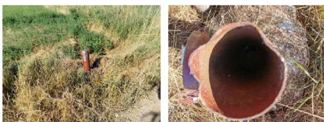
Illustration d'un piézomètre détérioré
