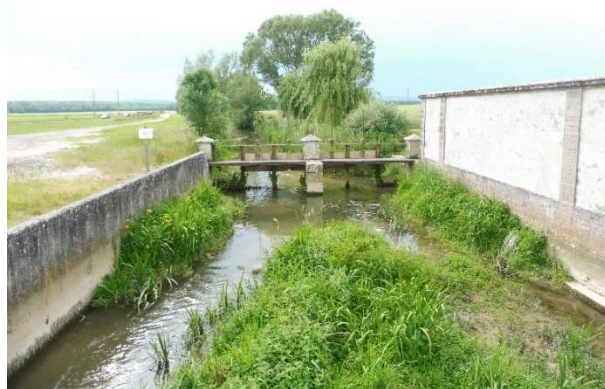
Ouverture permanente des vannes de Villebichot
